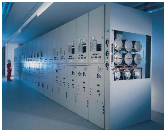
图 2：运行中的中压开关柜
